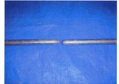
アンカーボルト軸部の破断 No5
