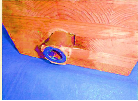
鋼管と接着剤の付着の抜け出し No1
